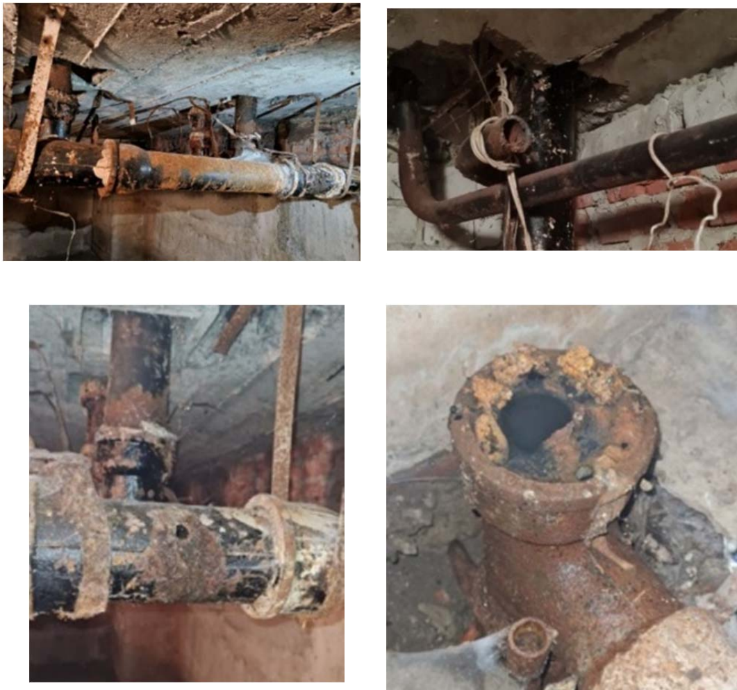
Рисунок 1 – Состояние системы водоснабжения и водоотведения в подвале корпуса ТГТУ, эксплуатация с 1992 года
